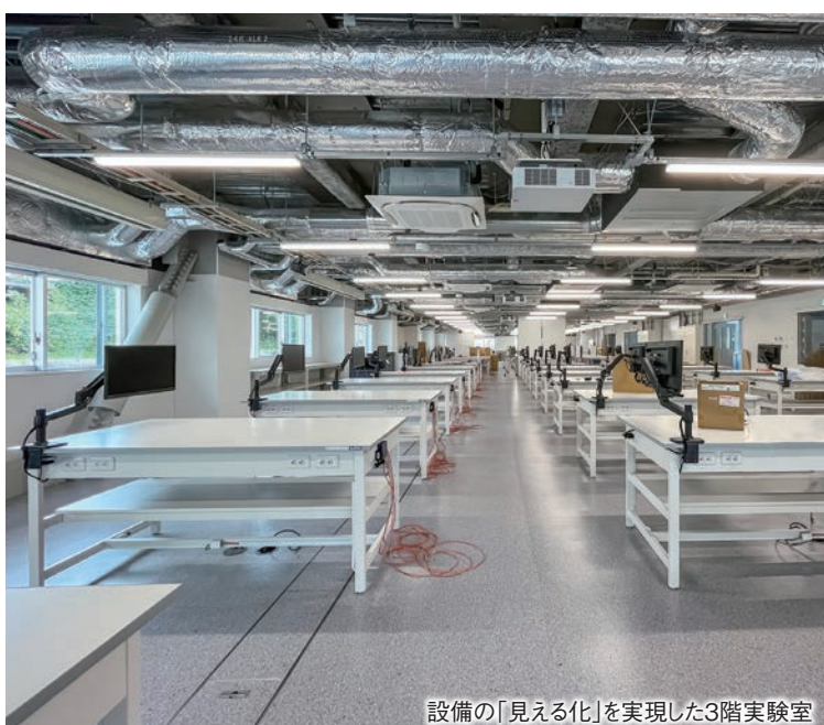
設備の「見える化」を実現した3階実験室
