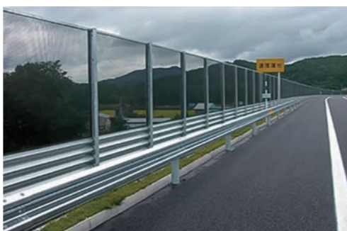
■防雪柵の設置状況
