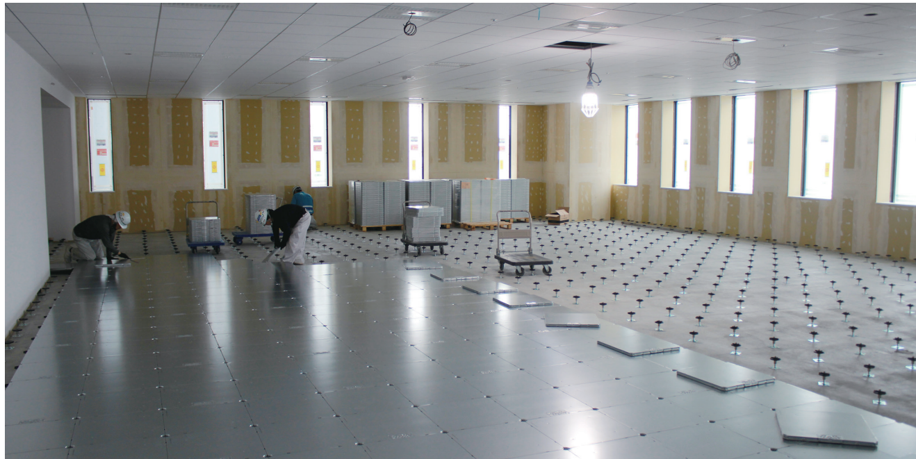
天井高2.8mの広々とした上層階のオフィスエリアではOAフロアの施工が進む
