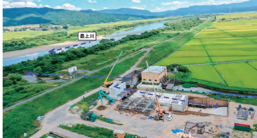
▲最上川下流左岸地区 大和排水機場
