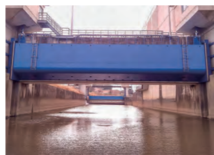
▲角田地区 江尻排水機場 第1制水門ゲート（施工後・下流側）
