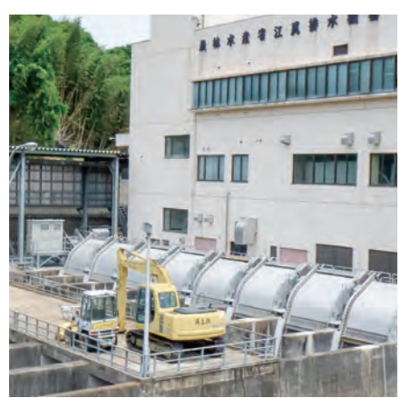
▲角田地区 江尻排水機場
