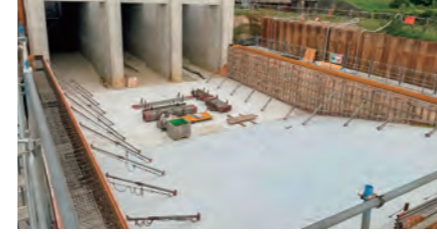
▲最上川下流左岸地区 大和排水機場 吸込水槽流入部 壁型枠組立
