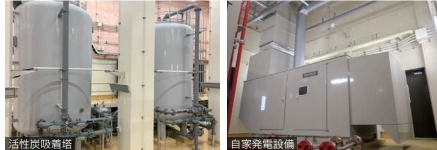
活性炭吸着塔
