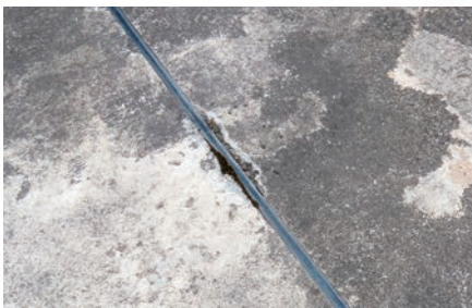
▲熱による劣化
