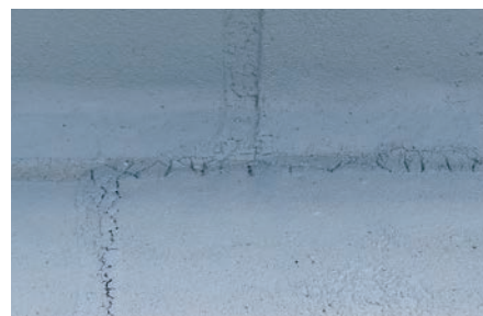
▲防水層のひび割れ
