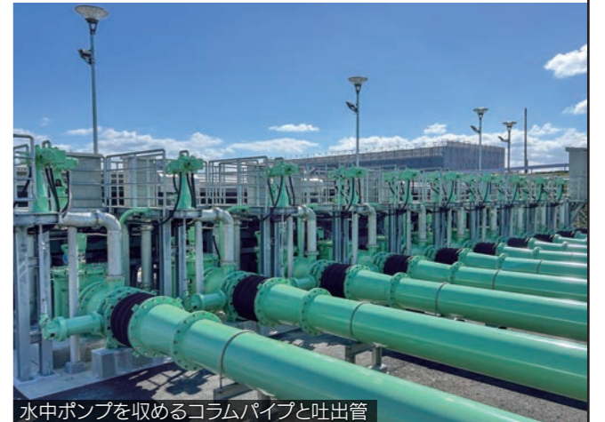
水中ポンプを収めるコラムパイプと吐水管
