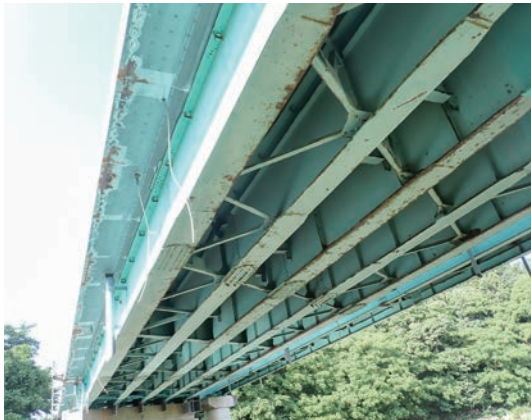
劣化橋梁 国道13号 横手川橋
