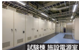
試験棟 施設電源室
